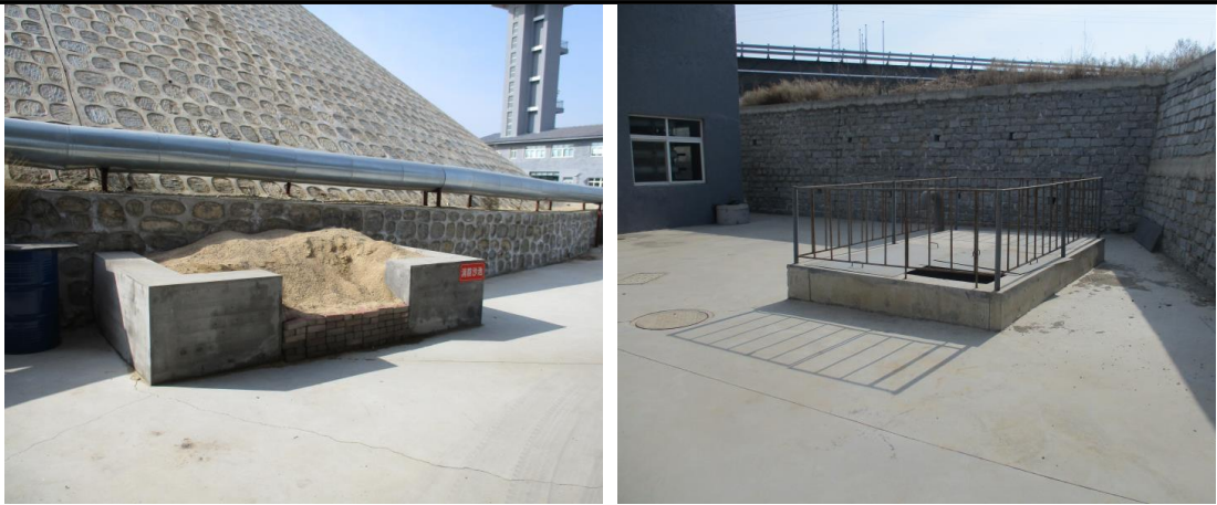
图 3-5 现场消防设施
