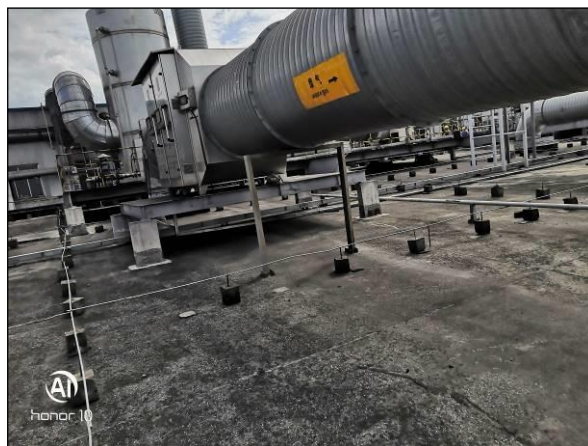
胶冷废气处理设施
