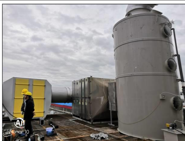
半钢 1#母炼 1 线废气处理设施
