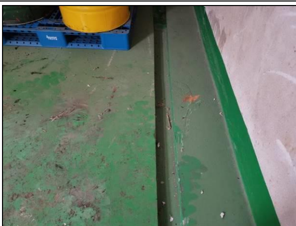
危险废物暂存间内导流沟
