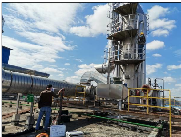
半钢密炼 1#2#3#终炼投料卸料门废气处理设施
