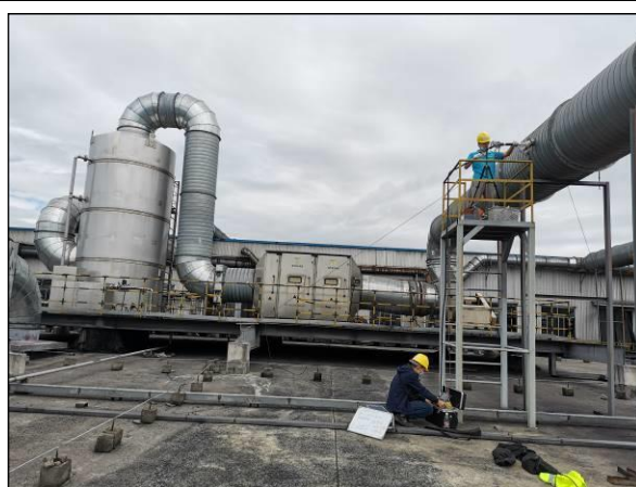
半钢密炼 1#3#母炼下铺机废气处理设施
