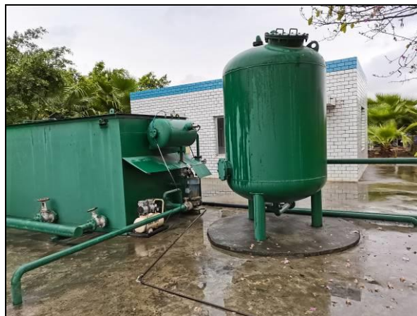
生产废水处理站
