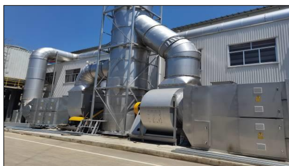
工程胎车间硫化废气处理设施
