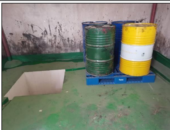
危险废物暂存间内收集池
