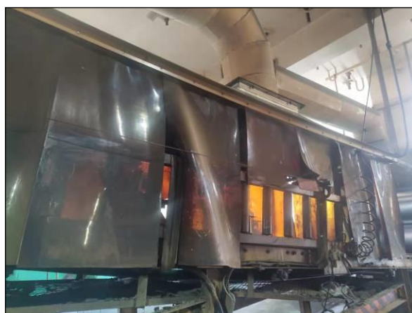
母炼下铺机集气设施
