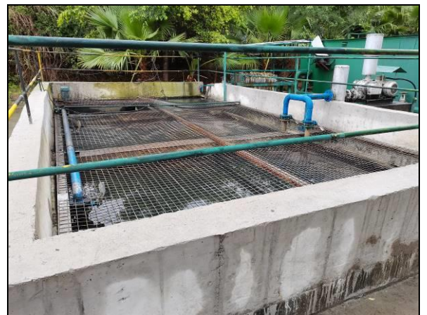
生产废水处理站
